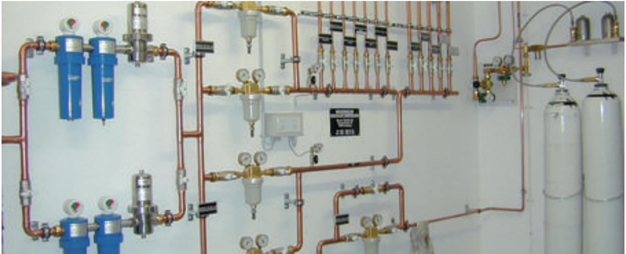
Das zentrale Leitungssystem ermöglicht die Versorgung der Patienten mit medizinischen Gasen.
