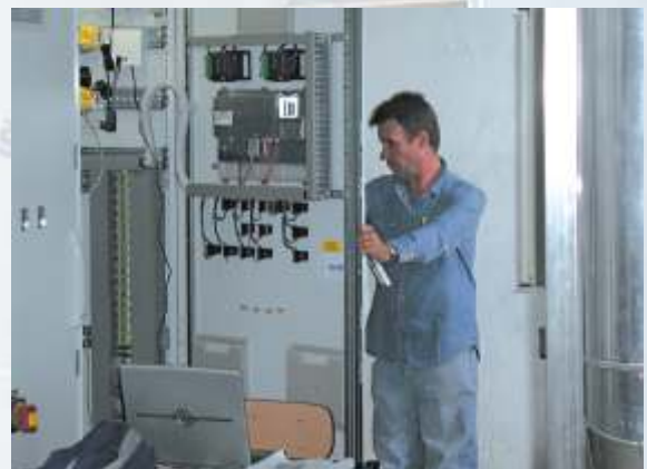
Brennand Hall, Projektmanager Verfahrenstechnik, nimmt eine Anlage in Betrieb.
